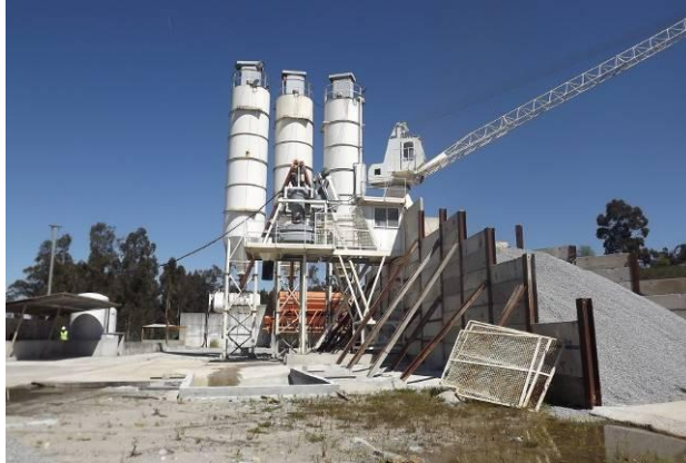
Fotografia 7 - Central de betão.
