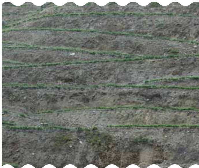
FIGURA 5 - Forma incorrecta de construir las terrazas: no existe paralelismo entre las terrazas, ocasionando taludes con alturas muy irregulares, graves problemas de erosión y baja rentabilidad de los trabajos en la viña.
