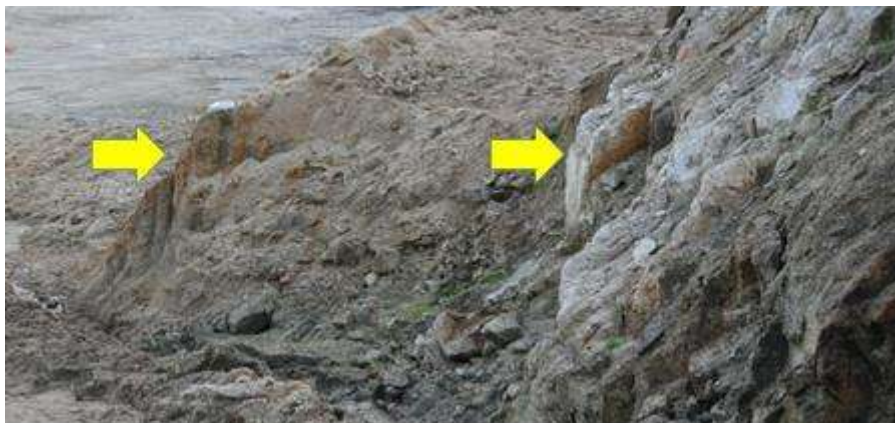
Figura 18 – Observação de oxidação presente no substrato granítico em terrenos na envolvente exterior da Eurocast Portugal Viana
