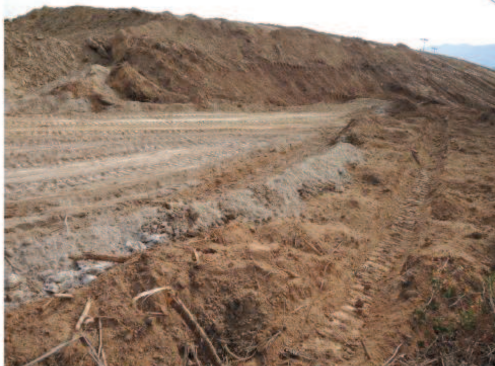
Fot.7 – Área com depósito de inertes.
