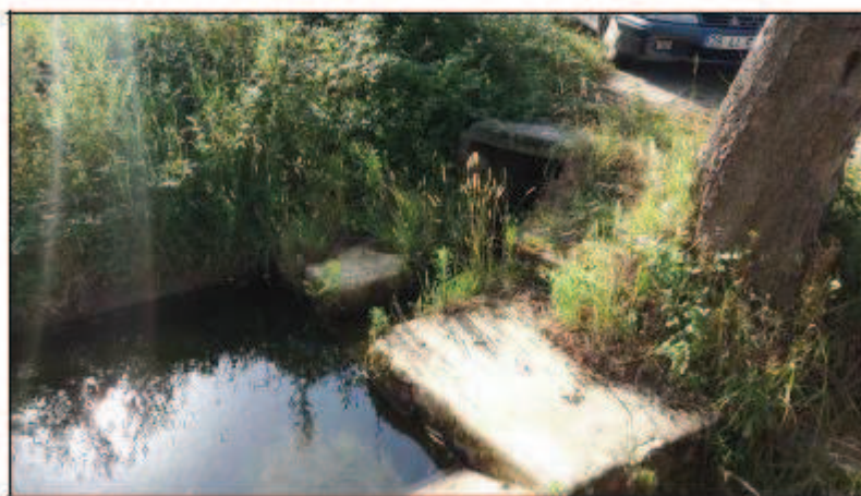
Fig. 2 – Tanque a montante da EN 306 (S3A)
