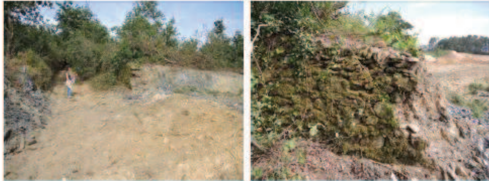
Fotografia 10 – Muro de propriedade que ladeia um caminho de terra.
