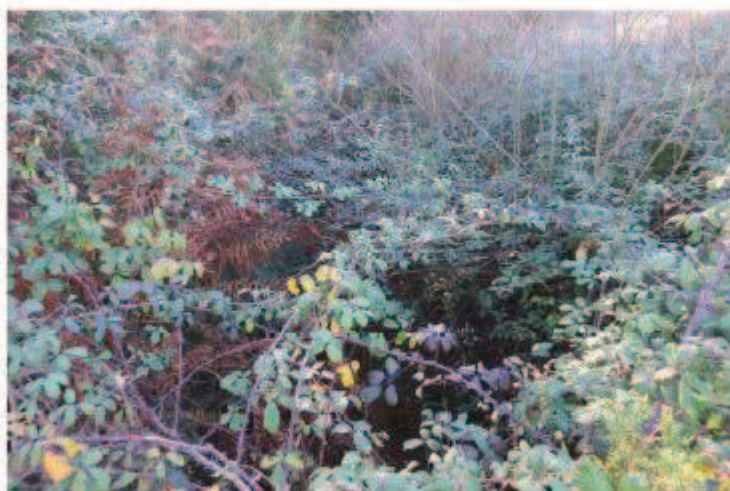
Fig. 7 – Obstrução por vegetação da linha de água a jusante da PH sob o CM 1184
