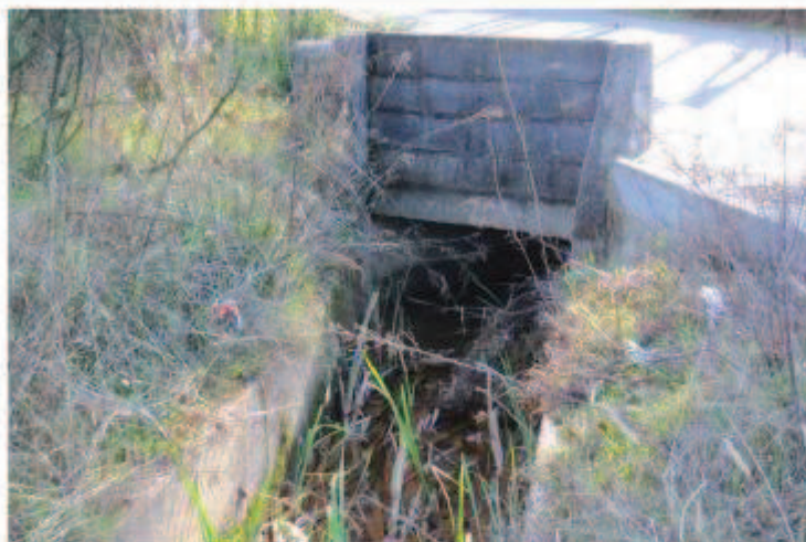
Fig. 6 – Vegetação a obstruir o canal de drenagem à entrada da PH sob o CM 1184 (S17.2)
