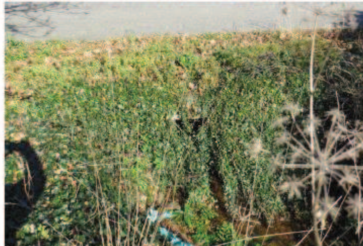
Fig. 5 – Ribeira da Golada - Vegetação a obstruir a saída da PH sob o CM 1185 (S4)
